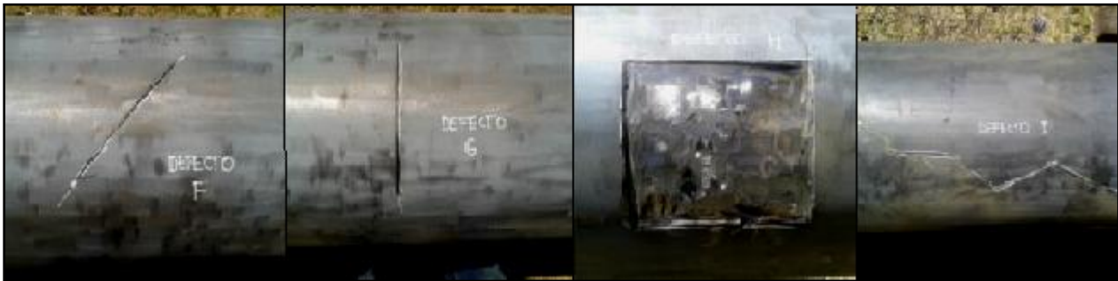
Figura 27. Defectos F, G, H, I.
