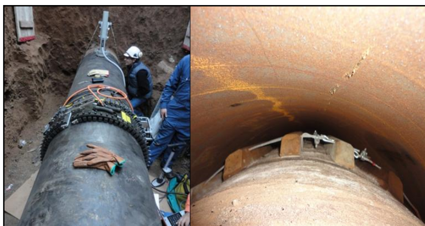
Figura 15. Izq: Inspección GWUT en Casing 30" en Ugarte y Panamericana-VL. Der: Inspección visual interna del encamisado.
