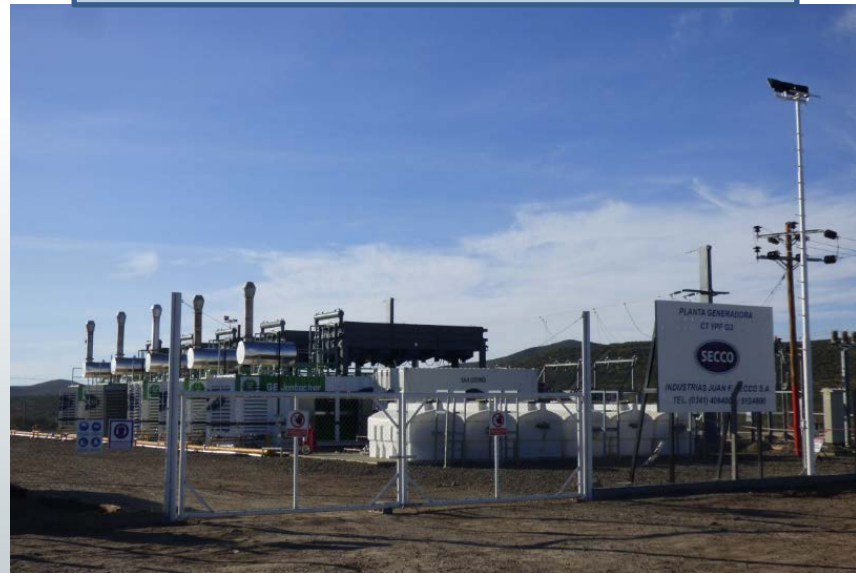
Central de Generación Escalante – G3
