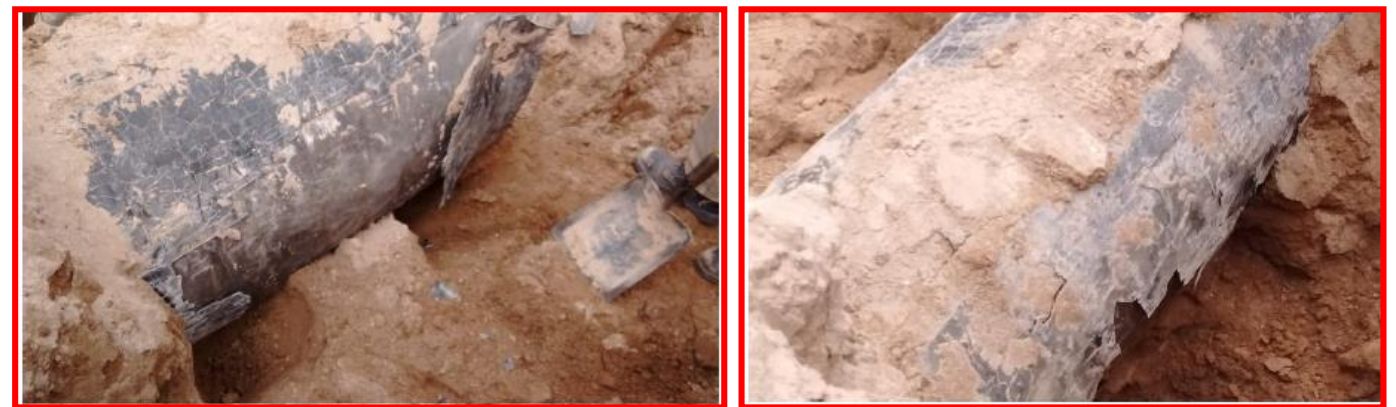
Intervención #6926, Revestimiento en mal estado.
