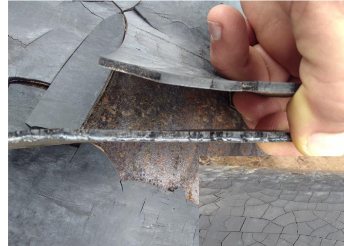
forma de la falla: agrietamiento generalizado.
