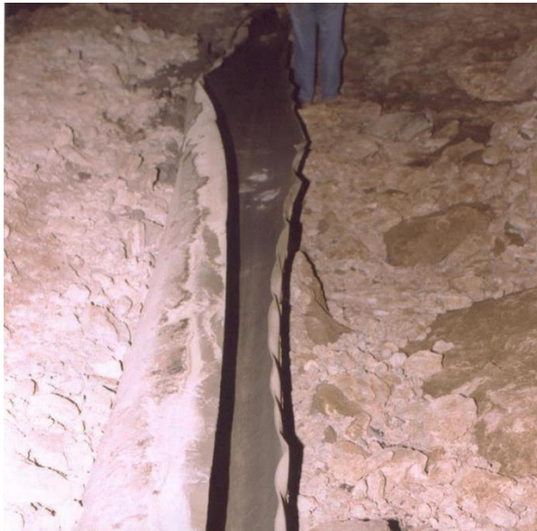
Rotura año 2000: Daño por terceros, propagación de fisura a través del cordón de soldadura
