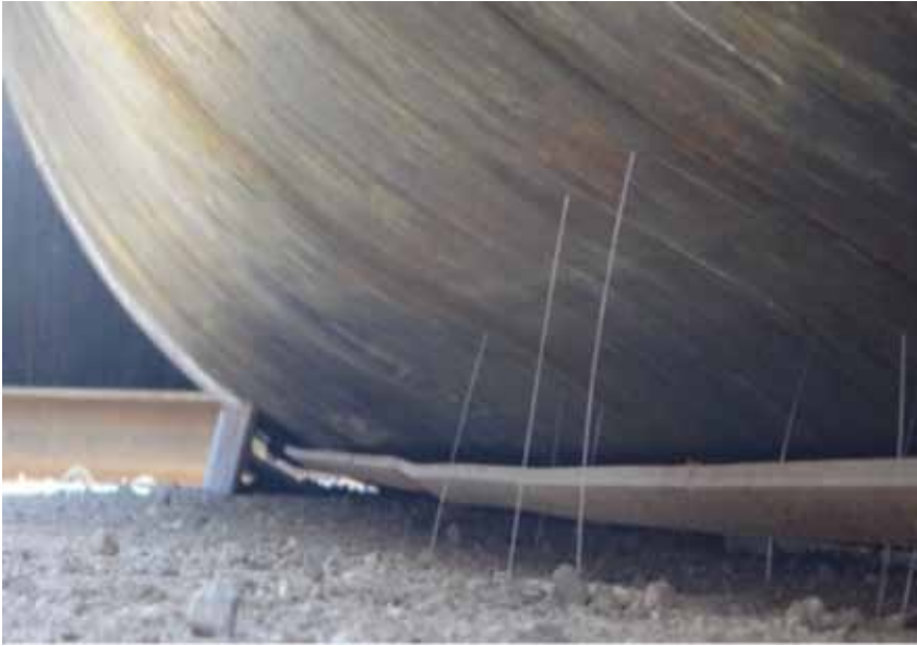
Figura 7. Alambres colocados para evidenciar restitución de la abolladura.
