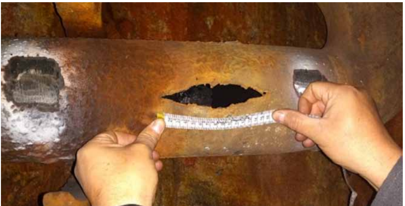
Figura 4. Falla encontrada en el tubo de la zona radiante.
