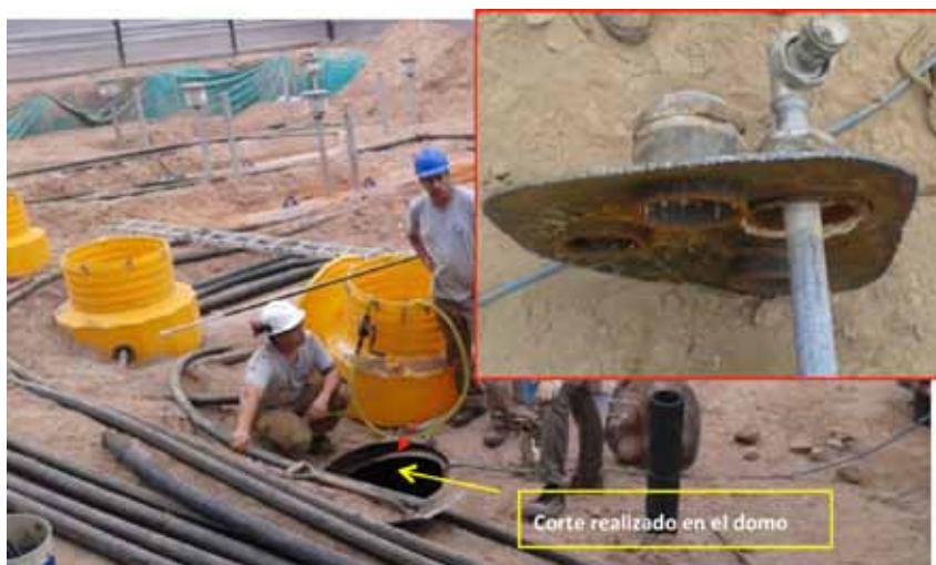
Figura 2. Intento de reparación del tanque ya enterrado.
