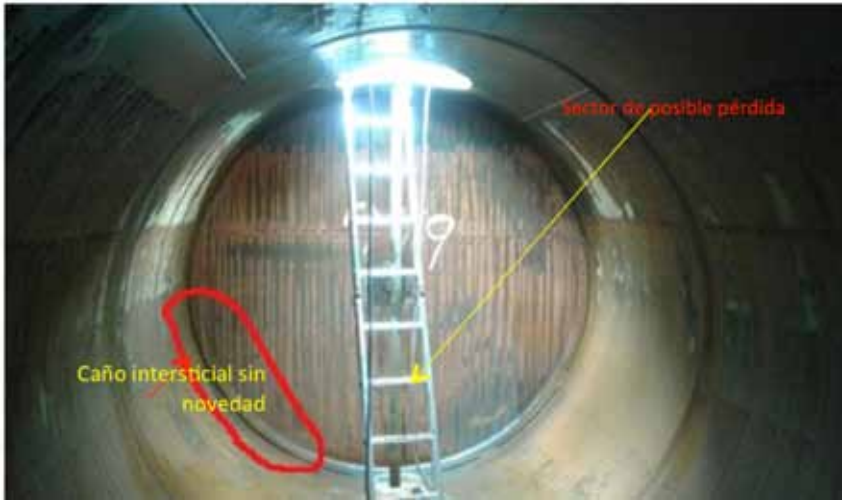
Figura 3. Vista interna, se indica zona de presunta reparación.
