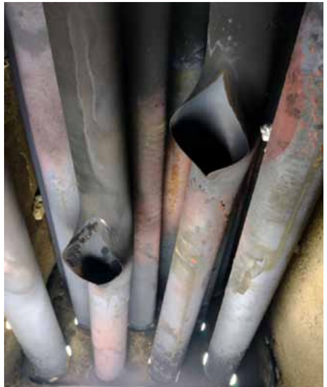
Figura 5. Fallas encontradas en los tubos de la zona convectiva.
