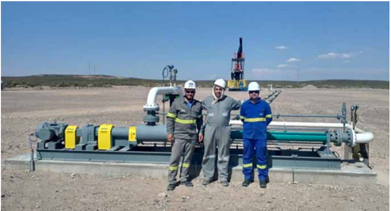
Figura 17. Montaje de PCP Superficial de Netzsch en pozo shale oil de PAE.
