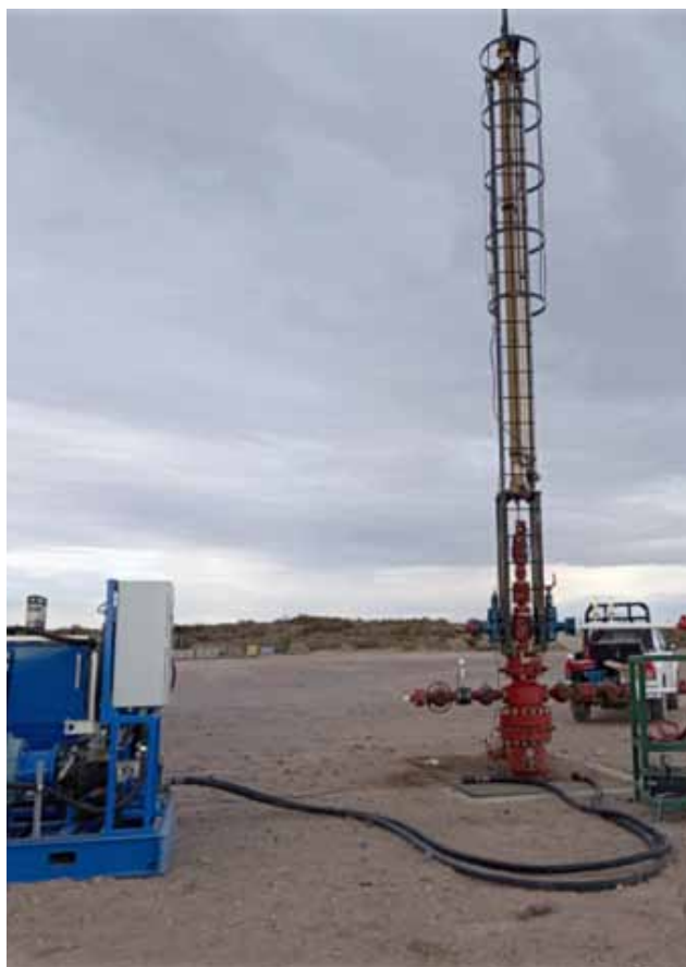
Figura 24. Unidad de bombeo hidráulica.
