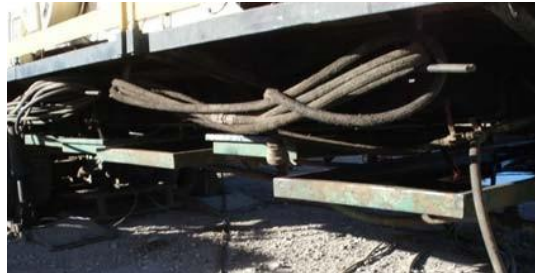
Imagen 8: Vista de bandeja colectora en cisterna
