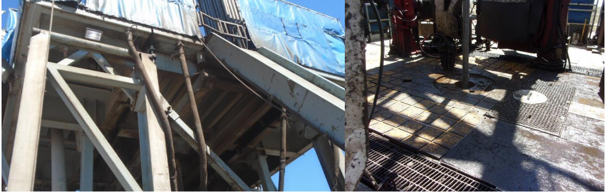
Imagen 6: Sistema de drenaje de la mesa a la bodega
